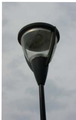
ARMATUUR OP MAST
