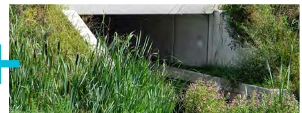
Droge verbinding in duiker als extra onderdoorgang
