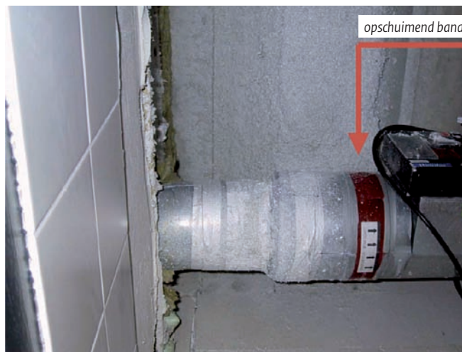
Een brandklep moet tot aan de opschuimende band brandwerend ingepakt zijn. Op de hier getoonde wijze aangebracht heeft de brandklep geen meerwaarde
