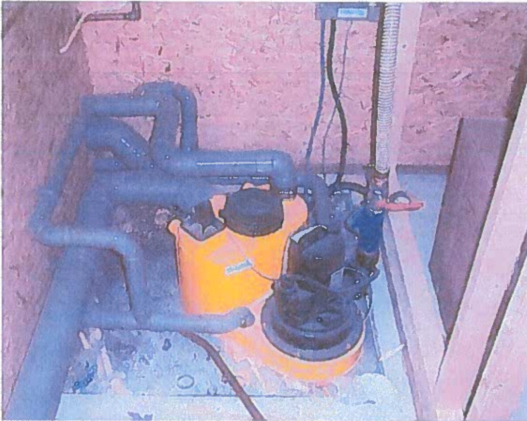
Foto boven: Roolpomp in drijvende woning Foto: ABC Arkenbouw
