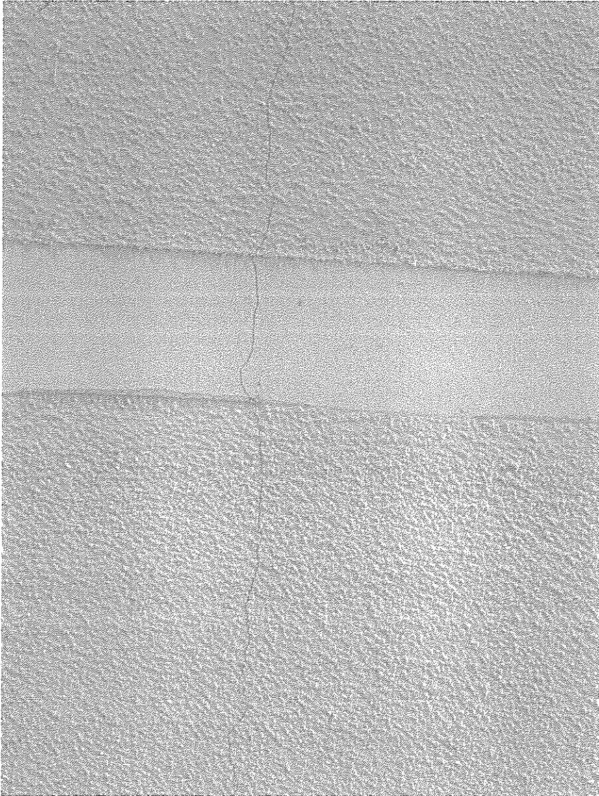
Foto 7 Verticale scheur in wand tussen JL8 en JL9
