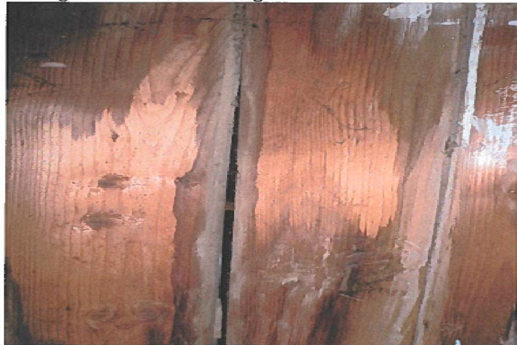
Sluiting dakbeschot onvolledig
