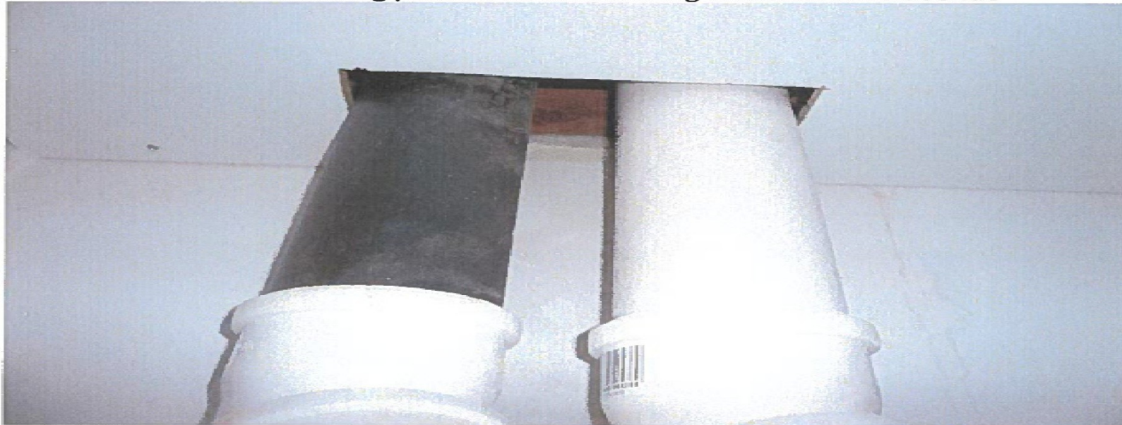
Plafond CV kast: Aftimmering plafond en doorvoering afvoeren onvoldoende
